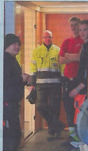
Opettaja Keijo Heinonen talorakentajien Juuso Puustisen, Toni Peuhkurin ja Juho Mannisen kanssa peruskorjaustyömaalla.
